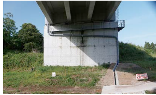
写真2(右) L2 で道路から川に続く排水パイプ
